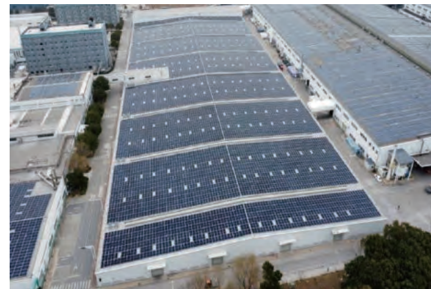
海信湖州空调工厂屋顶光伏
