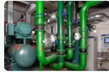
黄岛信息产业园空压机热能回用、蓄冷系统等设备
